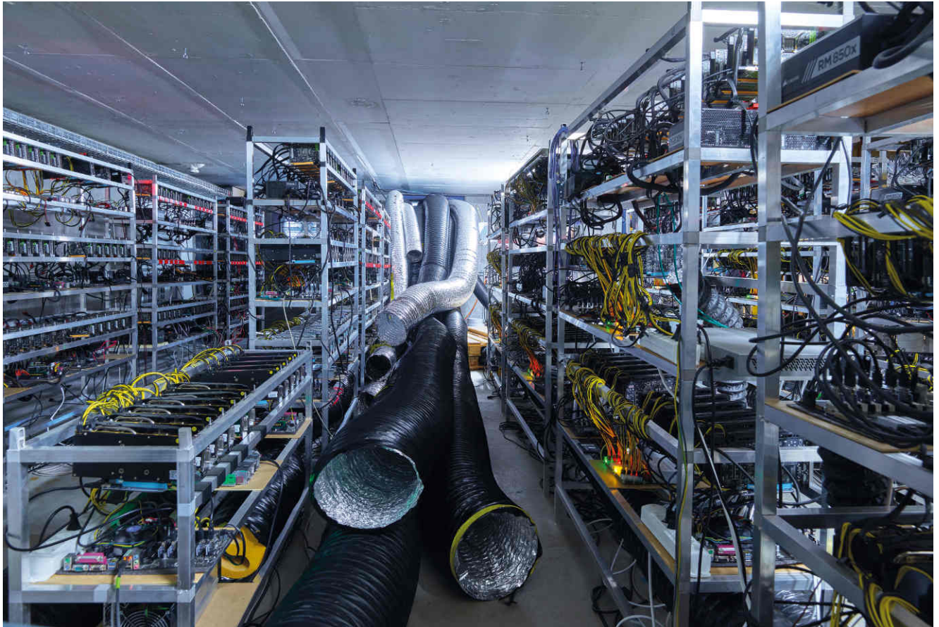
Speicheranlagen der Firma Alpine Mining in Gondo, Kanton Wallis. Die Rechenleistung der «Kryptowährungs-Mine» dient der Absicherung von Blockchain und Blockchain-Transaktionen (Aufnahme von 2018).
